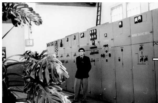
Joonis 1. Püssi elektrijaama peakilbi ees.
